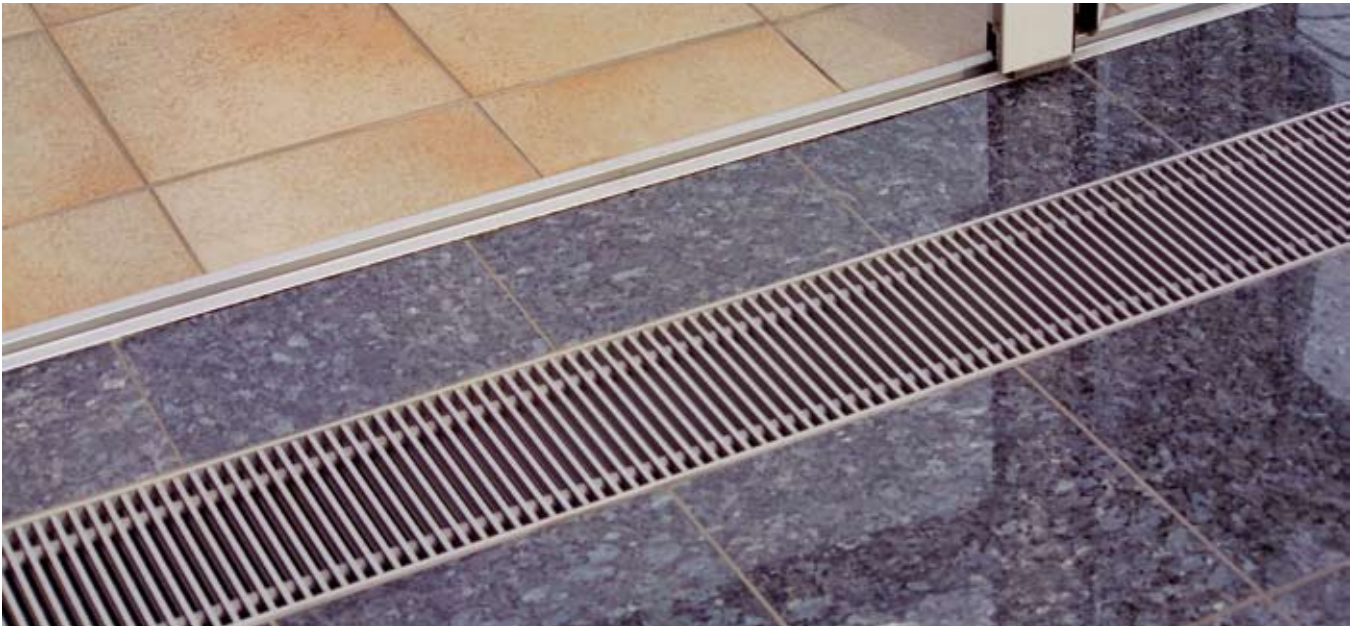
Konvektorenheizungen haben in Wintergärten den konstruktiven Vorteil, dass sie vollständig im Bodenaufbau „untergebracht“ werden können.
