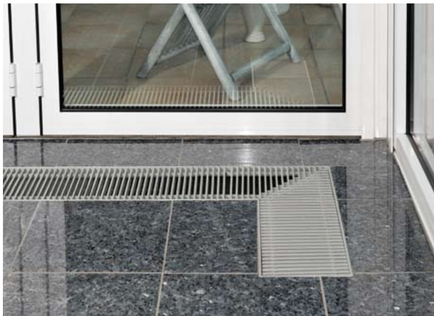
Der Einbau einer ausreichend dimensionierten Heizung, angeordnet an den kältesten Stellen, gehört zu den Grundaufgaben einer kompetenten, professionellen Planung und Ausführung im Wintergartenbau.
